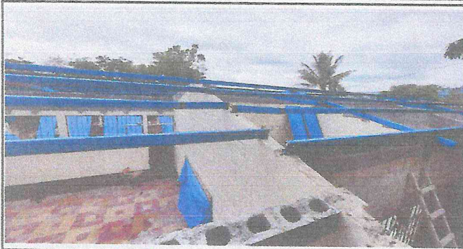
Foto 1: Nivelado de todas las paredes con bolck y fundiciones y corona de hierro.
